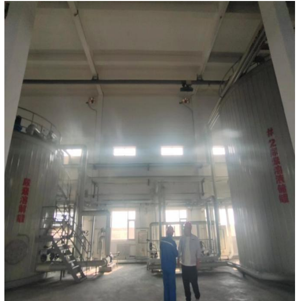
溶解、存储罐体
